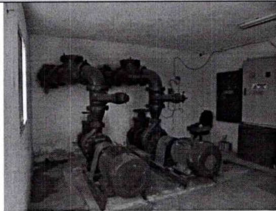
Descripción Registro Fotográfico: Bombas – Tablero Eléctricos
